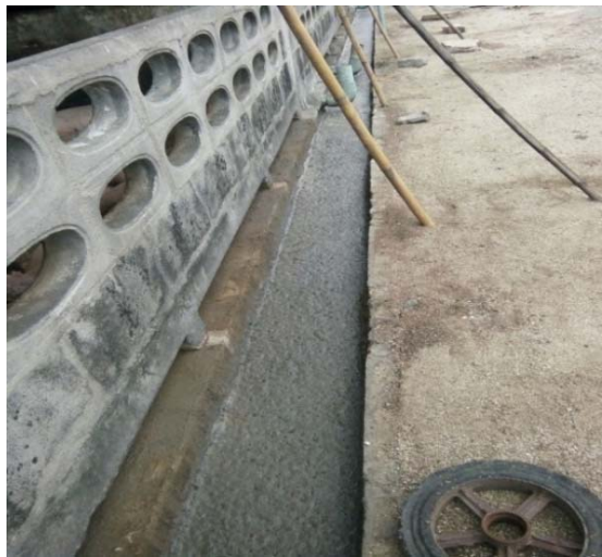
รูปที่ 1.7 รางระบายน้ำเสียที่ไม่ถูกสุขลักษณะ
