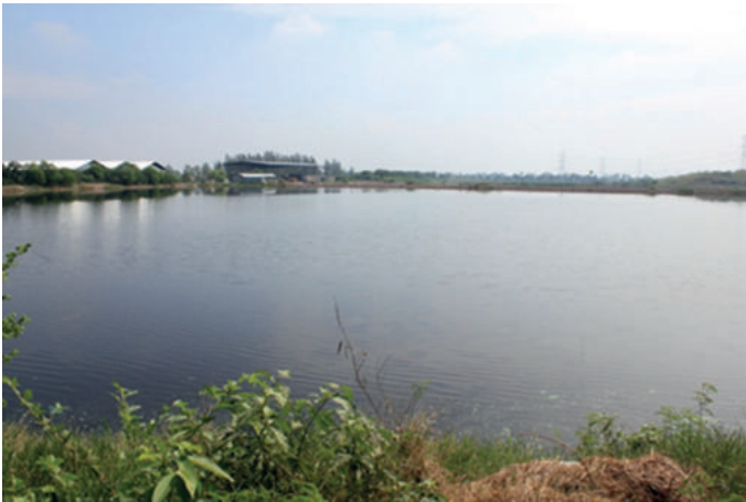
รูปที่ 5-10 ระบบบ่อปรับเสถียร (Stabilization Pond)
