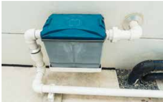
รูปที่ 46 บ่อดักไขมัน
