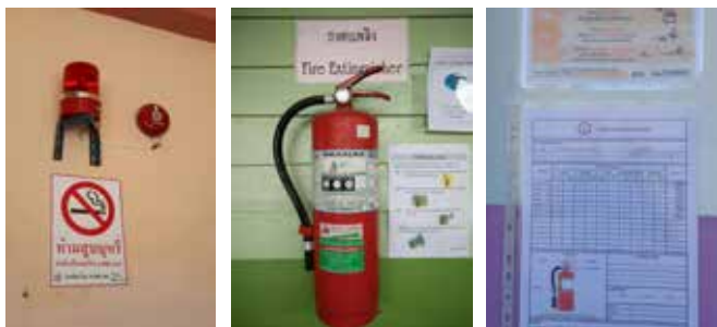
รูปที่ 19 การติดตั้งระบบสัญญาณเตือนภัยและถังดับเพลิงอย่างถูกต้อง
