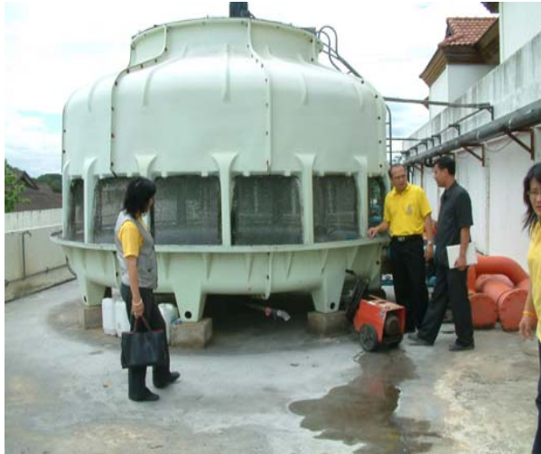
รูปที่ 10 แสดงการตรวจสอบระบบหอผึ่งเย็น
