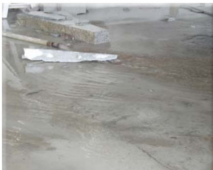
สภาพน้ำเจิ่งนองบริเวณพื้นปฏิบัติงาน
